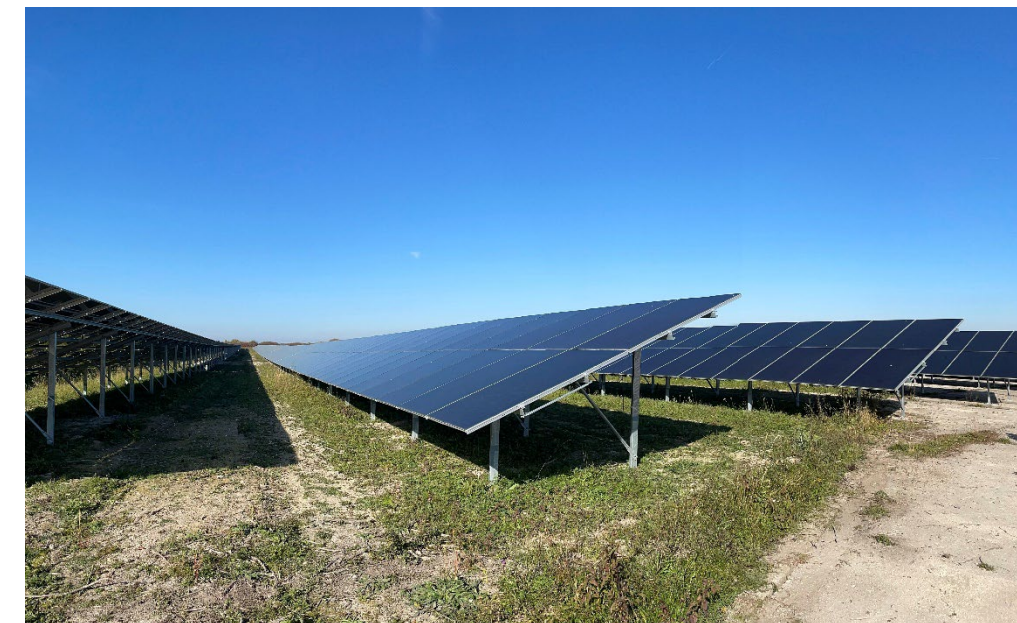
Figure 6 : Exemple d'installation photovoltaïque réalisée à Marigny (51) par le porteur de projet
